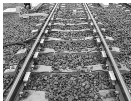
Рисунок 4 – Путевое оборудование комплекса WCM
