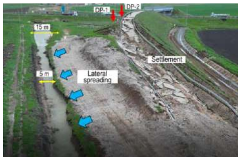
Рисунок 6 – Вызванное разжижением боковое распространение и повреждение насыпи
