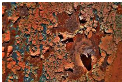
Рисунок 1 – Коррозия на металлических конструкциях
