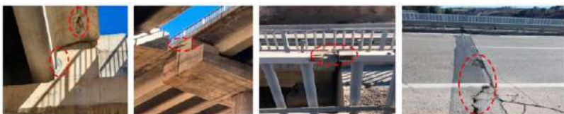
Рисунок 2 – Повреждение моста Адьяман Аксу
