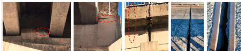
Рисунок 3 – Повреждение моста Адьяман Чендере
