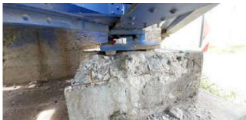
Рисунок 4 – Вид на поврежденную опору железнодорожного моста
