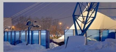
Рис 2. Обрушение тентового покрытия от снеговых нагрузок
