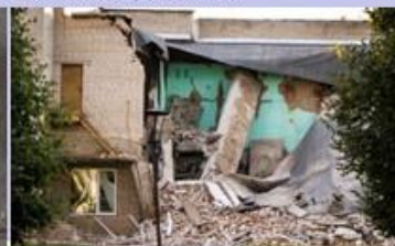
Рис. 2 Обрушение части Кривческой школы 29 августа 2014 г.
